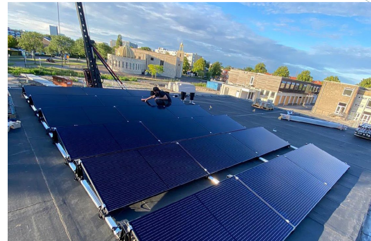
De zonnepanelen op het dak van de gymzaal: de kluswoning van John en Sylvia.
